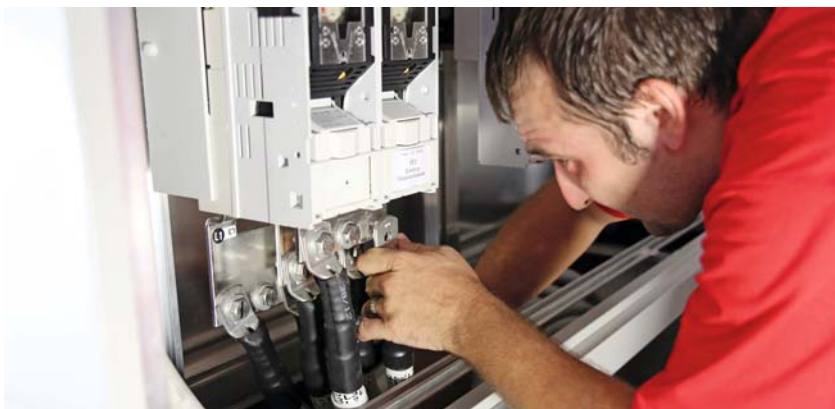
Verteilung PV-Anlage: Anschluss Eingangssicherungen mit je 2 x 240 mm 2 Cu-Querschnitt pro Polleiter.
