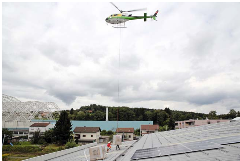
Die über 2300 PV-Module werden in 1,5 Flugstunden aufs Dach gehoben. Hinten links: die Sondermülldeponie Kölliken SMDK.
