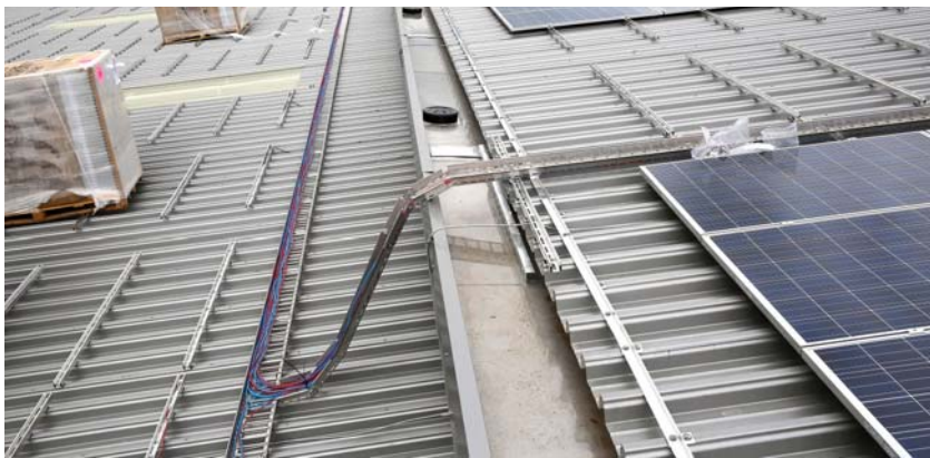
Edelstahl-Kabelkanal mit Verbindung über Dach-Versatz.
