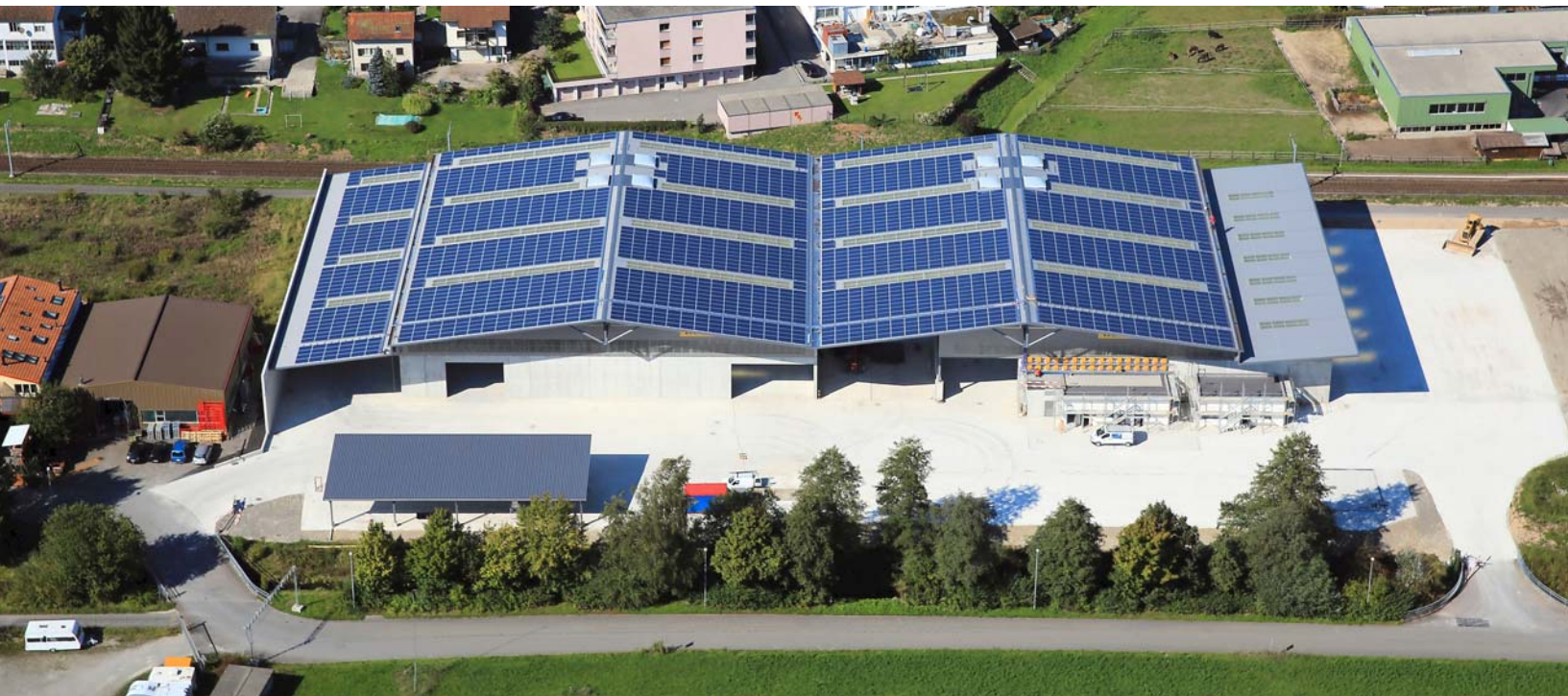
Luftbild von Süden. Rechts unter dem Dach sichtbar: die 32 Wechselrichter SolarMax 15MT2.
